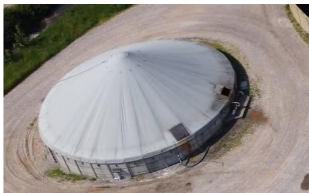
Figur 2.3: Industri-fortank med fastoverdækning
